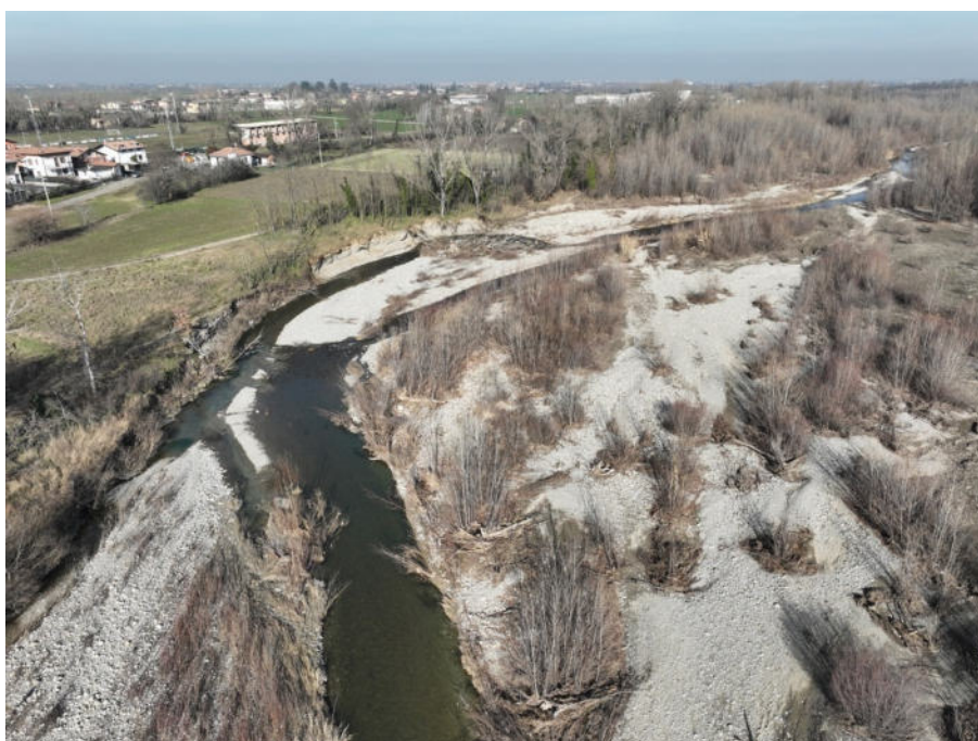
Vista dell'alveo del Torrente Staffora a valle del ponte sulla SP461 con fenomeni erosivi in sponda sinistra
